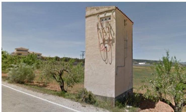
Figura 164. Centro de transformación en Letur. Carretera CM-3225 (fuente: Google maps).
