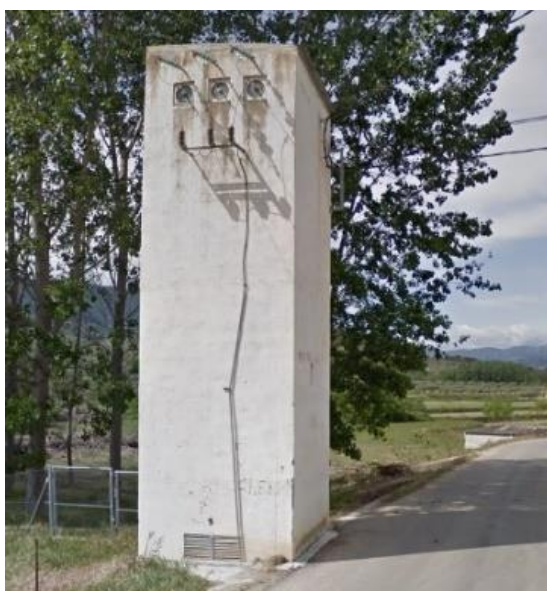
Figura 168. Centro de transformación en Casas del Pino, La Dehesa de Iznar (fuente: Google maps).
