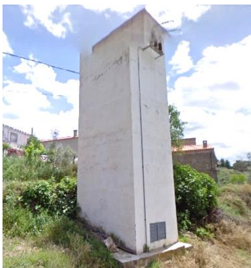
Figura 167. Centro de transformación en Las Casas, La Dehesa de Iznar (fuente: Google maps).
