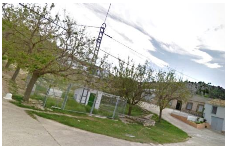
Figura 166. Centro de transformación en Fuente La Sabina (fuente: Google maps).
